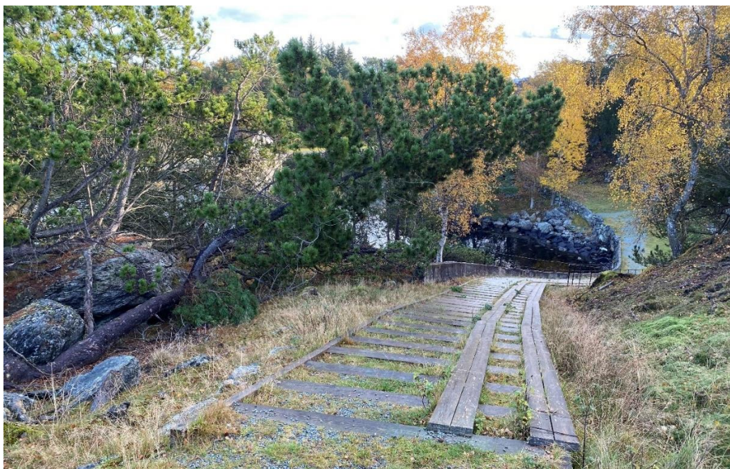
Figur 7.12. På stien på vei nordover fra flaggstanga har det blitt anlagt en trapp. Denne framstår svært glatt og bør kles med hønsenetting eller lignende for å gjøre den mindre glatt.
